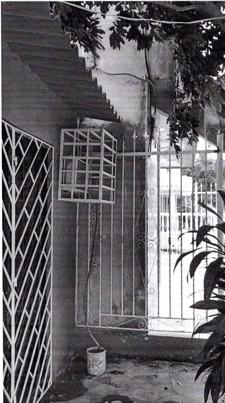
MURO POR SALE DE LA LINEA DE PARAMENTO DE CONSTRUCCION
