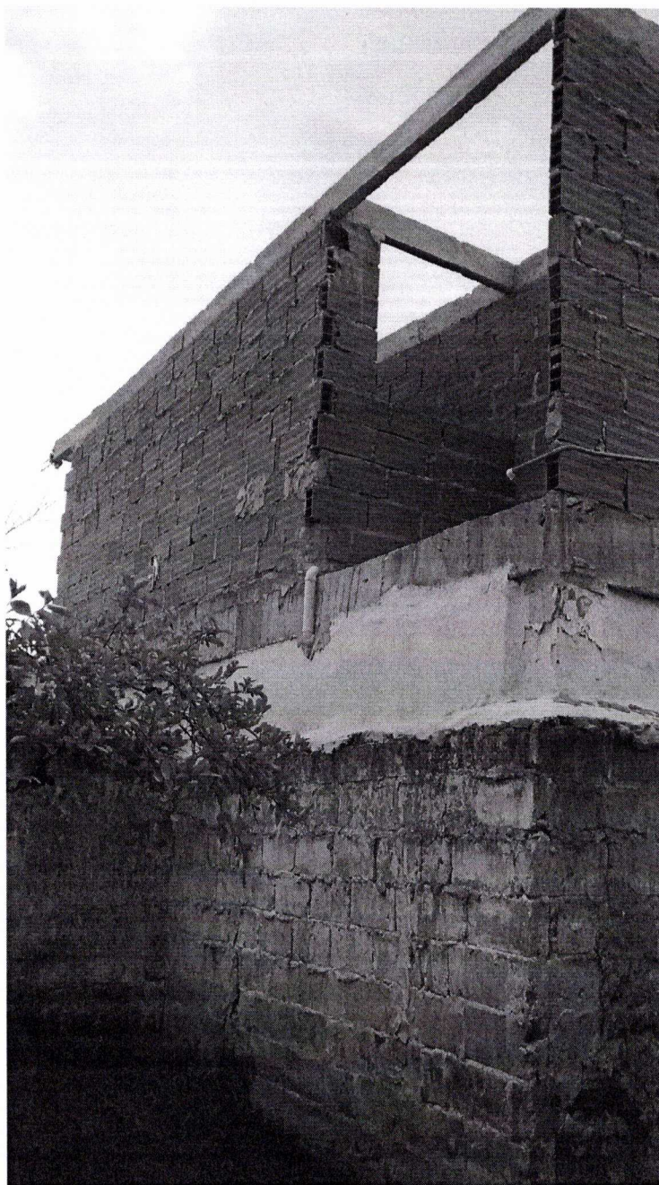
MURO POSTERIOR CON LOTE COLINDANTE
