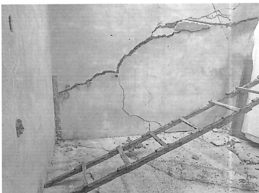
Fracturas y grietas en muros de vivienda evacuada ubicada al lado del hallazgo del diapiro por INGEOMINAS año 2012
