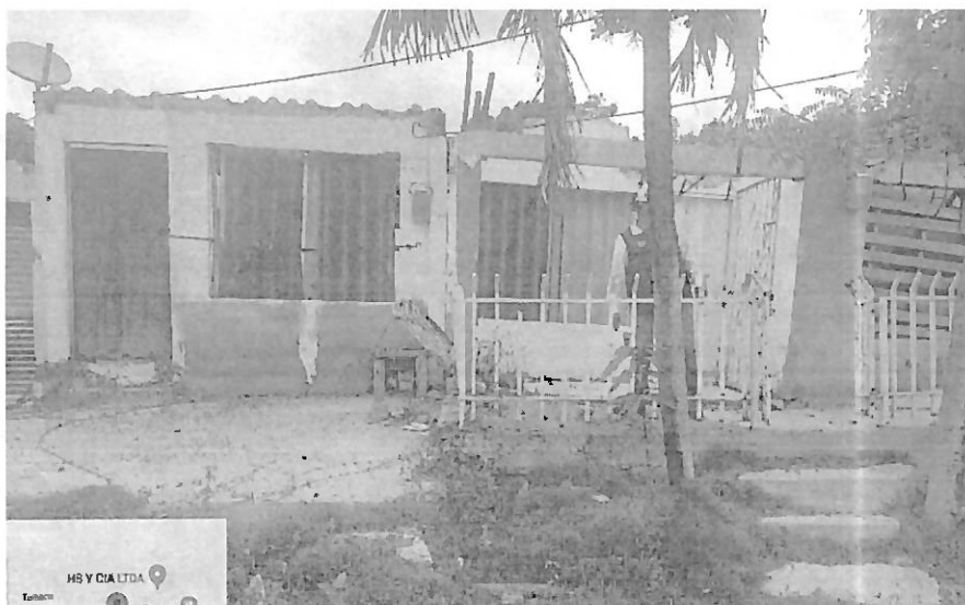
Viviendas evacuadas por afectaciones estructurales graves
